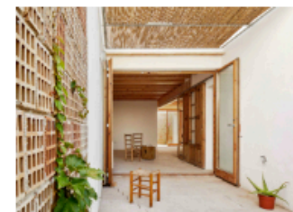
Fotos de les obres (prototip) Avanç de les obres de construcció de les 14 habitatges a Sant Ferran, Formentera
